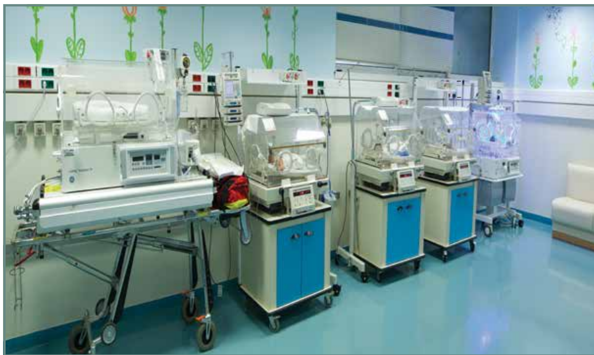
Εικ. 2. Άποψη της ΜΕΝΝ ΜΗΤΕΡΑ, Επίπεδο II.
